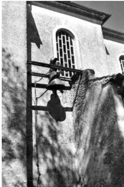
Fig. 2 - La campana posta lungo il lato meridionale prima dei restauri dell'edificio (Foto Gianfranco Abrami).
